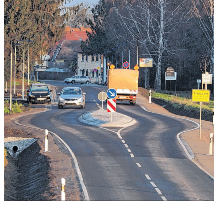
Die Landesstraße durch Hessen ist bis Dezember 2019 einschließlich aller unterirdischen Leitungen erneuert worden. Jetzt soll der Straßenbau in Nebenstraßen fortgesetzt werden. Foto: Mario Heinicke
